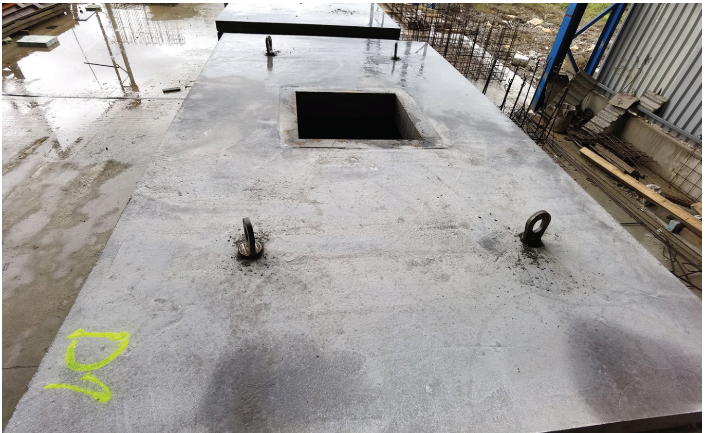
Nehézbeton kész tároló D1 jelű
