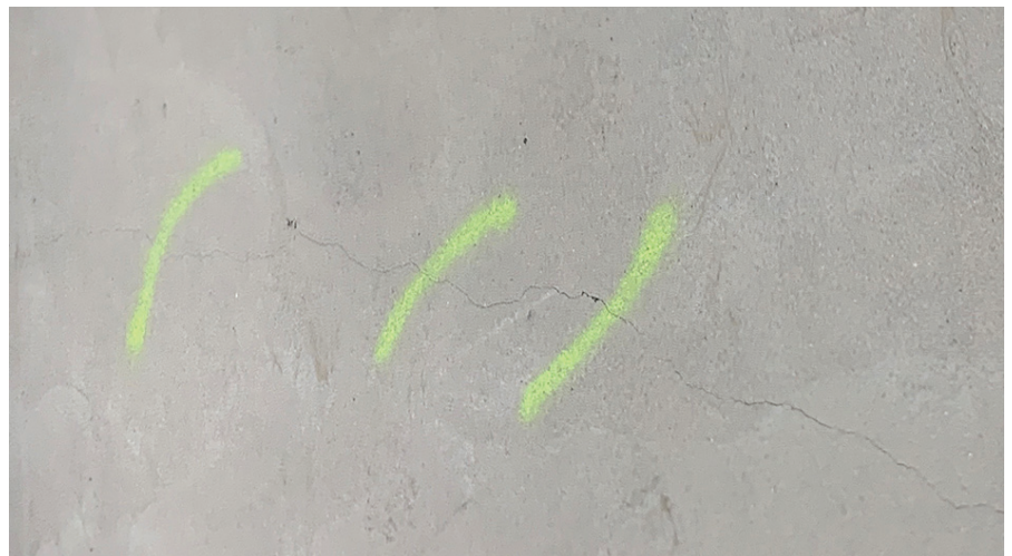
1. kép: 0,2 mm-es tágasságú hajszálrepedés, ami nem korlátozza sem a rendeltetésszerű használatot, sem a padlólemez tartóssága nem csökken. Nincs szüksége javításra műszaki szempontból, ha nem változik a repedés állaga.
