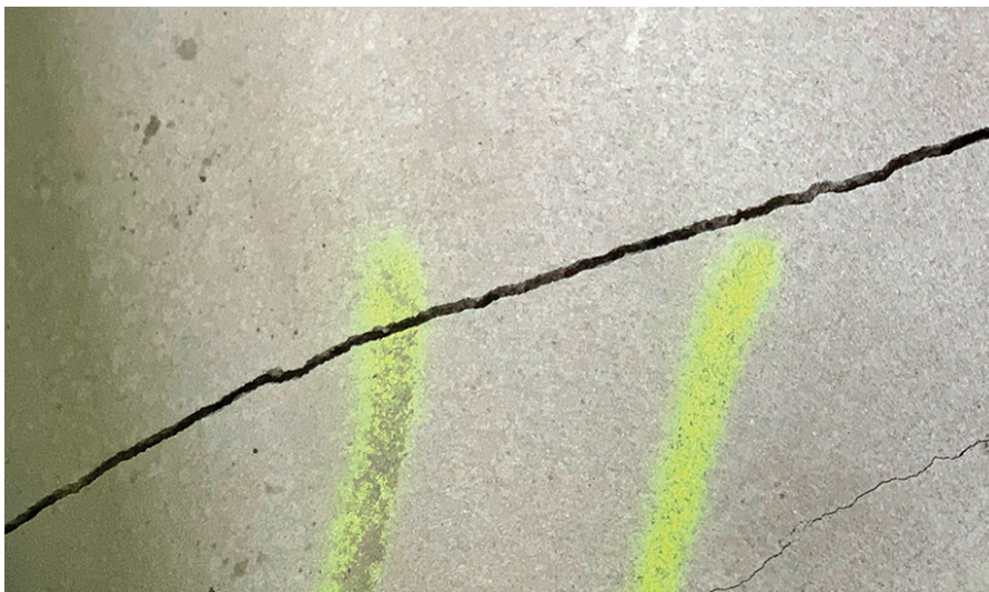
2. kép: 3 mm-es tágasságú, szerkezeti repedés. Tágassága miatt megszűnt a teherátadási képesség az elvált lemezsínek között, repedészél-tetőredezés, táblabillegés, erodálódás várható, ezért szükséges a javítás.
