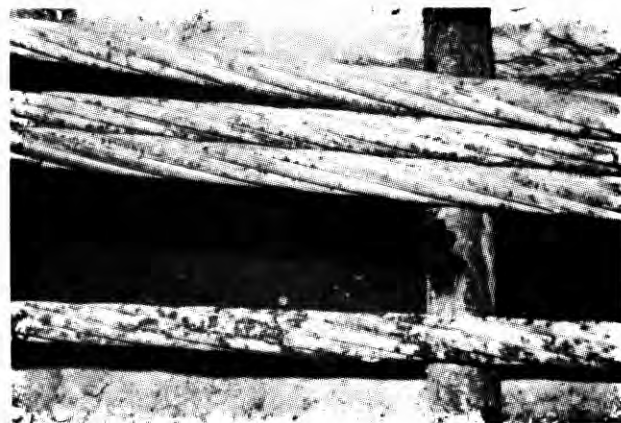
3. kép Általános korrózió feszítőhuzalon
